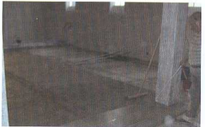
Kurz darauf beginnen die Fliesarbeiten. Die Baustelle streht mit großen Schritten ihrer Fertigstellung entgegen.
