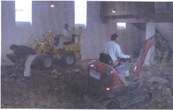
Der notwendige Komplettabruch des alten Fußbodens erinnert eher an Zerstörung denn an Sanierung.
