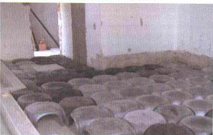
Die Dalliformen im Altarraum sind teilweise fertig verlegt. Im Hintergrund erkennt man das fertige Fundament des neuen Taufsteins
